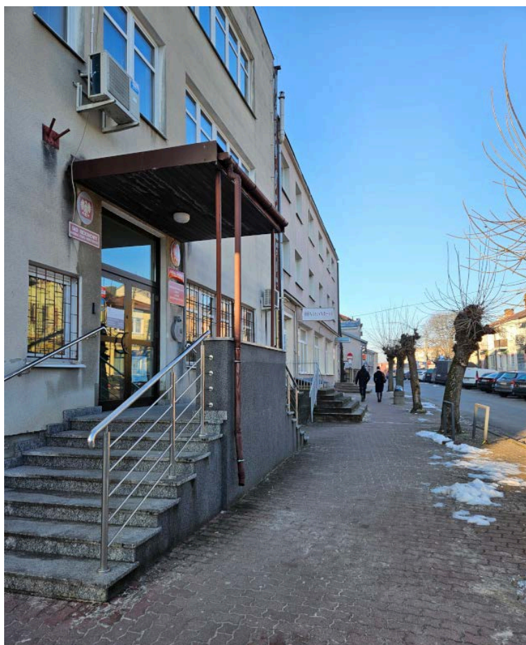
Zdjęcie 12. Przykład występujących w przestrzeni obszaru rewitalizacji barier architektonicznych fol. Janusz Jeżak
